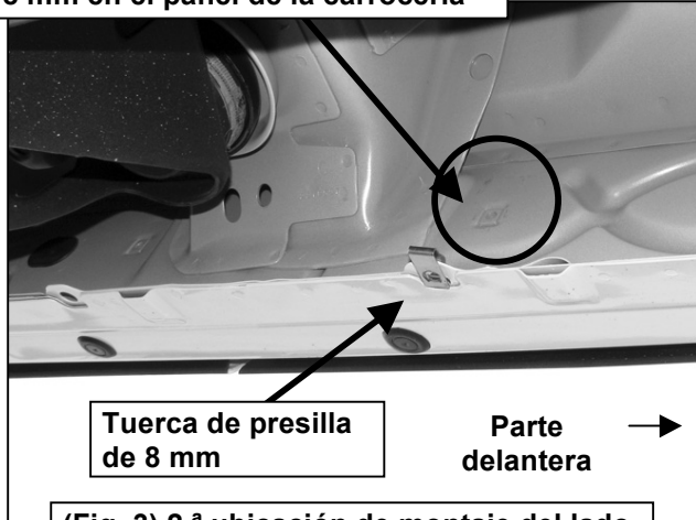
(Fig. 3) 2.ª ubicación de montaje del lado del conductor
